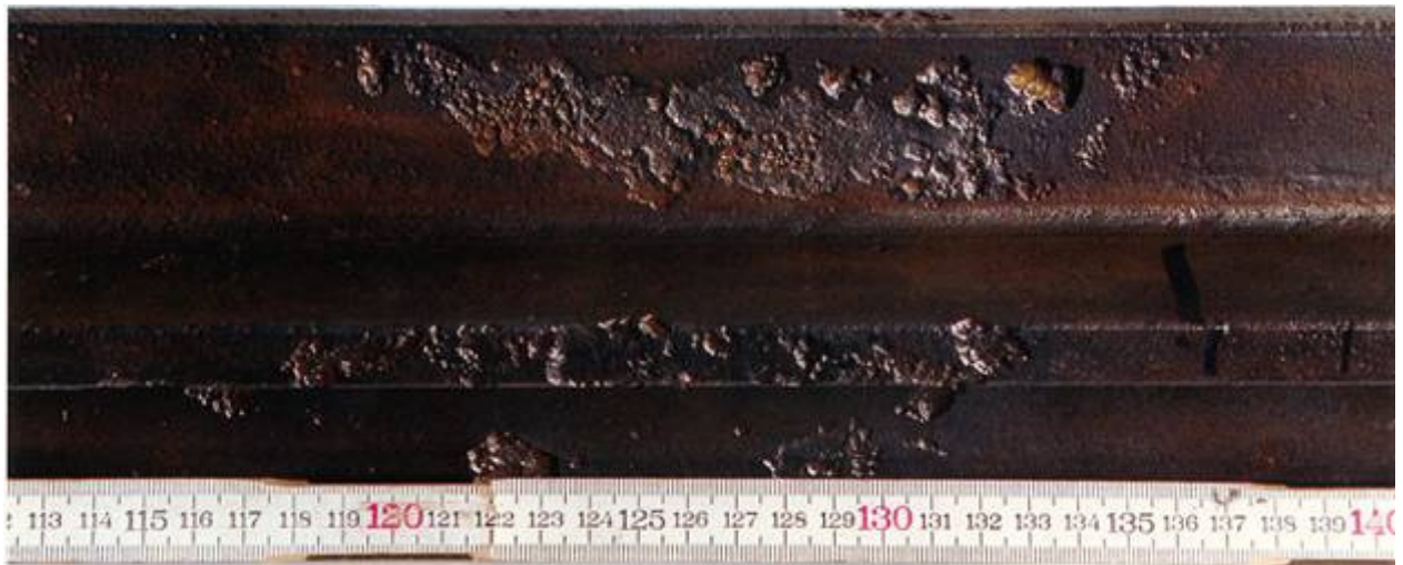
Figur 4.4 Påle exponerad 9 år i sand över grundvattenytan på provningsplats Linköping, Kolbytte- mon, Övre. Lokala korrosionsangrepp med många förhållandevis djupa frätgropar i posi- tion 1,15 – 1,4 m under tryckplattan på pålens övre ände. Den djupaste frätgropen är 2,3 mm.
