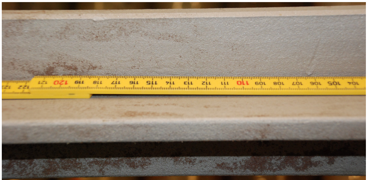
Figur 5.14 X-påle (påle nr 17), som exponerats neddriven i jord på provningsplats Stockholm Skå under 27,2 år. Djupet under markytan till skarvplattan var 0,5 m. Tumstocken på bilderna visar avståndet från skarvplattan. Medelkorrosionshastigheten för hela pålen var 7,5 \mu\text{m}/\text{år} .
