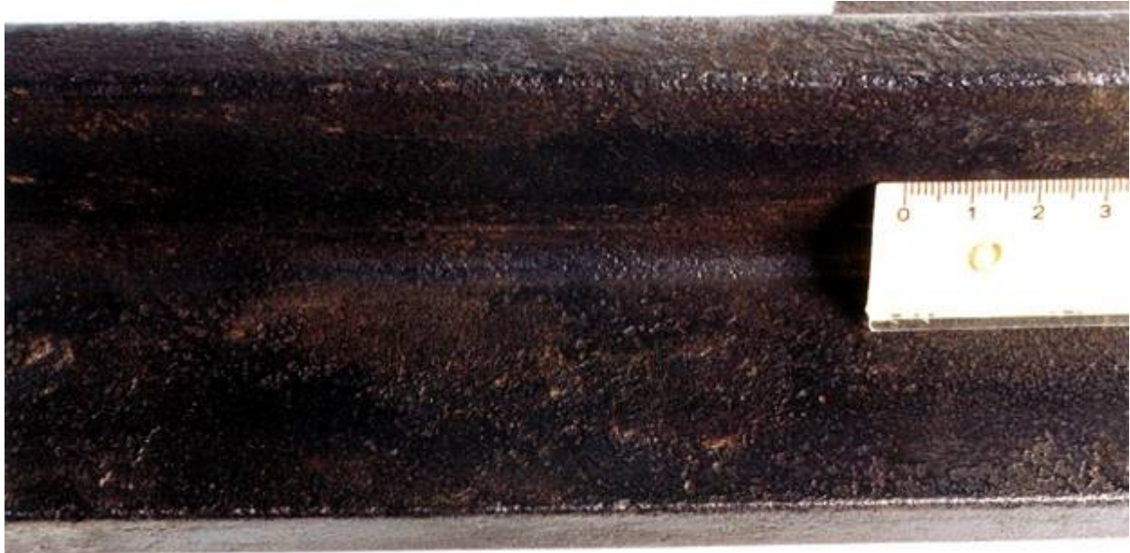
Figur 4.6. Påle exponerad 9 år i vattenmättad grusig sand under grundvattenytan på provningsplats Linköping, Kolbytte-mon, Nedre. Angreppens position: 0,1 – 0,25 m under tryckplattan på pålens övre ände. Jämn avrostning med små och grunda frätgropar. Maximalt frätgropsdjup: 0,3 mm.
